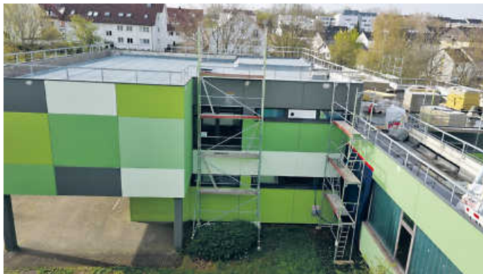
Energetisches Sanieren senkt den Energieverbrauch – wie hier an der Realschule Öhringen Foto: Stadt Öhringen
